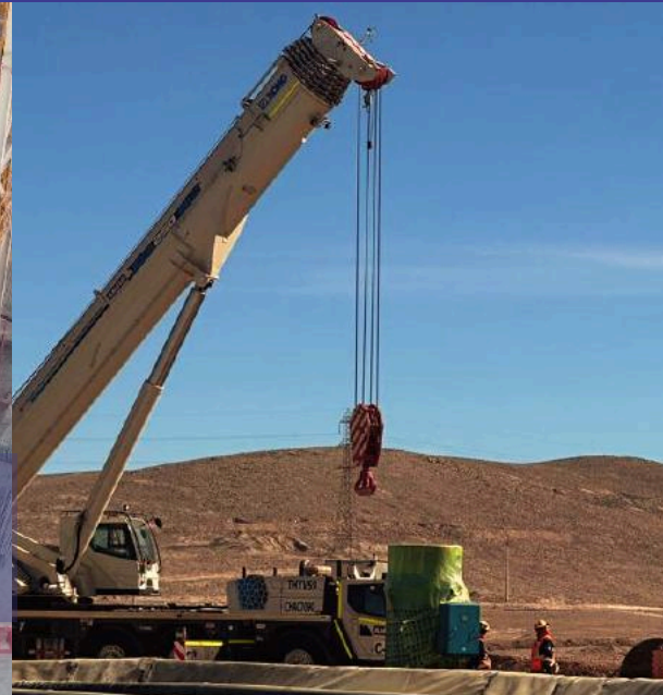
Servicio de Fabricación y Montaje Colector de Polvo N° 5 y 6., Minera Spence BHP.
